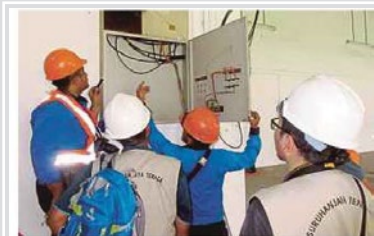
PEGAWAI ST dan TNB memeriksa penyambungan bekalan elektrik haram di sebuah premis.
