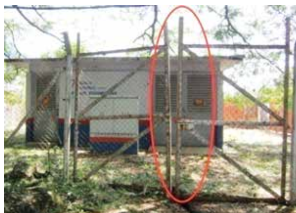
Pintu pagar pencawang tidak ditutup dengan sempurna
