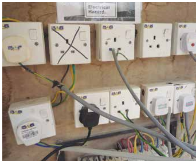
Pendawaian tidak selamat pada pemasangan sementara di tapak pembinaan
