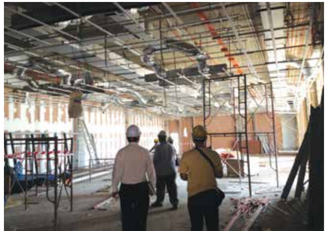
Pemeriksaan ST terhadap Orang Kompeten dan kontraktor elektrik di tapak pembinaan bangunan pejabat di Putrajaya
