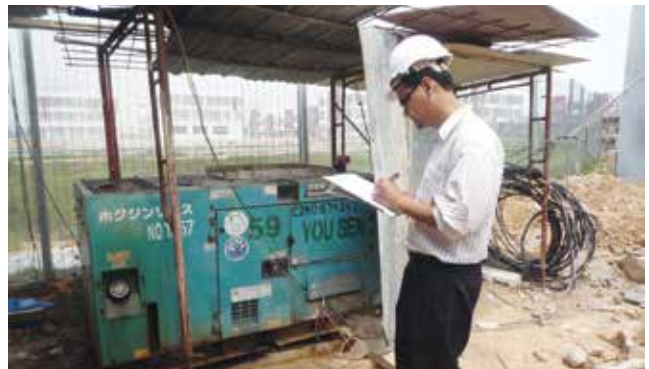
Pemeriksaan pemasangan jana kuasa oleh pegawai ST
