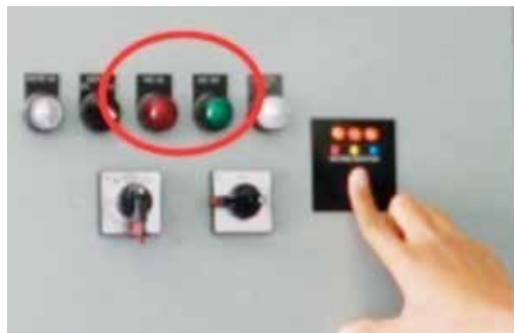
Lampu penunjuk status pemasangan tidak berfungsi
