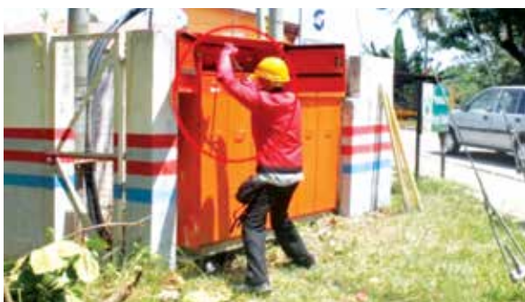
Peralatan Perlindungan Diri (PPD) tidak dipakai dengan lengkap
