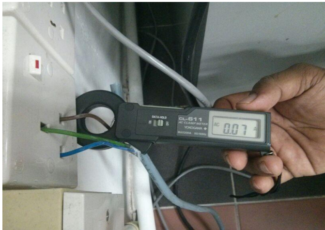
Semasa printing rehat (tidak berfungsi 0.07A) tetapi power supply 13A tidak OFF
