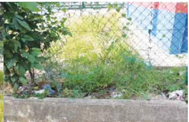
Keadaan pagar di pencawang TNB yang rosak memudahkan pencerobohan
