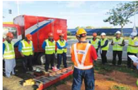
Kakitangan TNB mendengar taklimat daripada AP ketika kerja-kerja di PE Simpang Airport, Terengganu.
