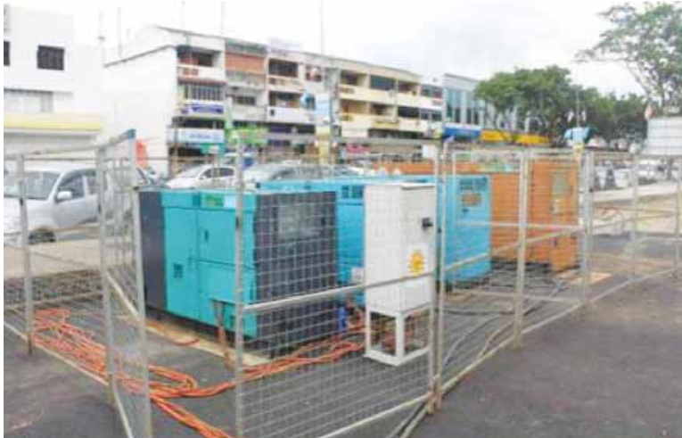
Keadaan pendawaian pemasangan yang tidak teratur
