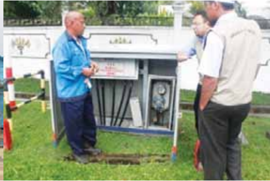
Pemeriksaan ke atas salah satu pemasangan milik TNB
