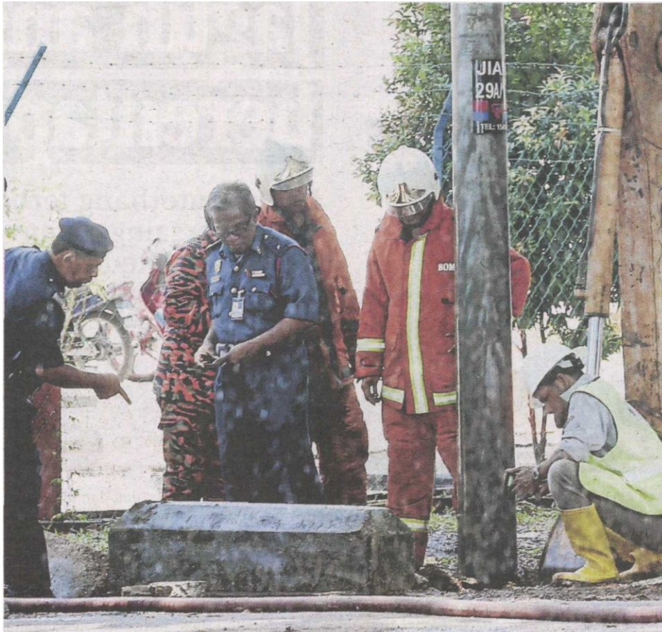
ANGGOTA bomba memeriksa tempat kejadian saluran paip gas bawah tanah yang bocor.
