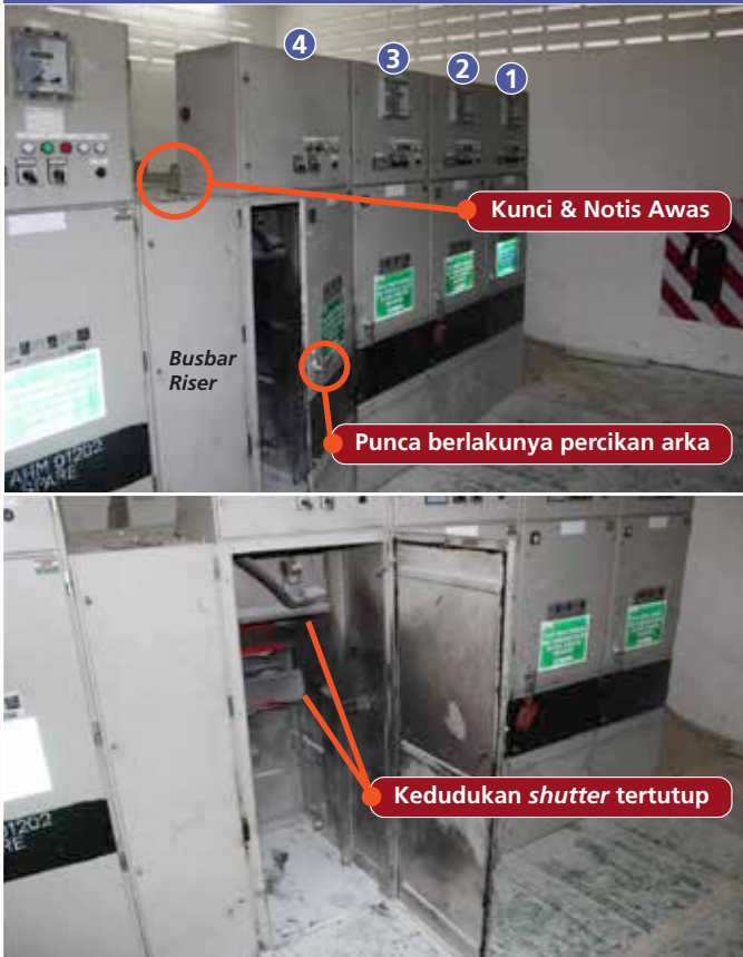
Gambar 11: Kedudukan panel-panel di dalam pencawang elektrik terlibat
