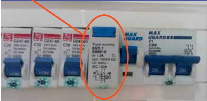
Gambar 8: PAB yang tidak berfungsi
