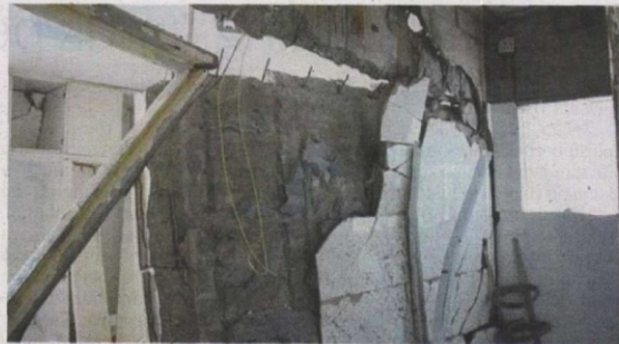
DINDING rumah lelaki Britain berkenaan retak teruk kesan letupan kuat daripada alat pemanas air di siling tandasnya di Kondominium Mont Kiara Palma, Kuala Lumpur semalam.
