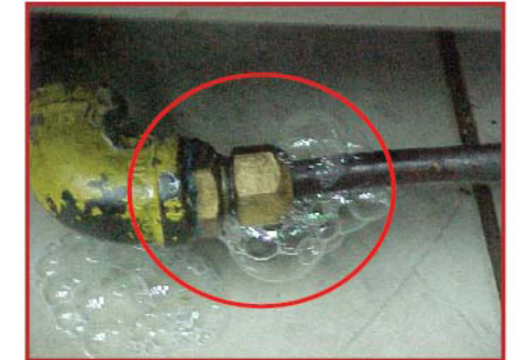
Kebocoran pada sambungan terakhir paip gas
