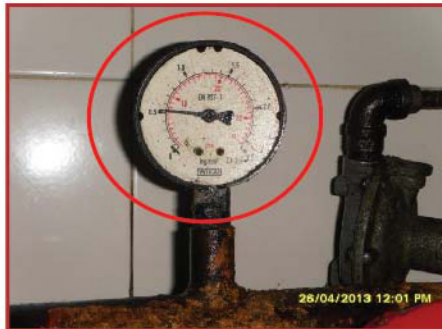
Tolak tekanan gas tidak berfungsi dengan baik
