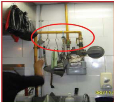
Paip gas dijadikan tempat menyangkut barang
