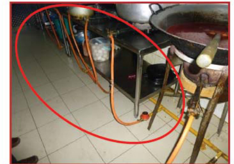
Hos gas yang digunakan melebihi panjang dibenarkan
