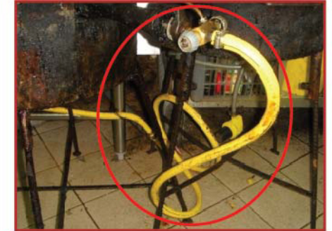
Hos gas yang digunakan melebihi panjang dibenarkan
