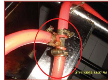
Kaedah sambungan hos yang tidak dibenarkan
