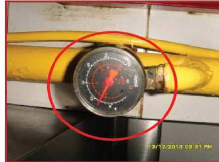
Tekanan gas melebihi tekanan yang dibenarkan
