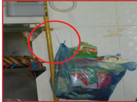
Paip gas dijadikan tempat menyangkut barang
