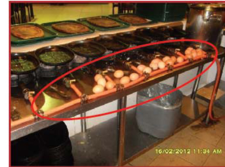
Kaedah sambungan hos yang tidak dibenarkan
