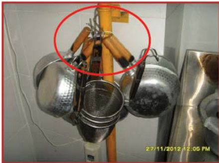
Paip gas dijadikan tempat menyangkut barang
