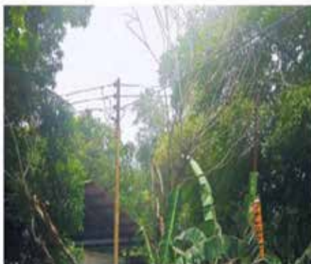
TINGGI: Tiang elektrik tanpa 'tay' menyebabkan sambungan wayar ke rumah pengadu diikat sangat tegang sehingga menyebabkan kerosakan pada sambungan.
