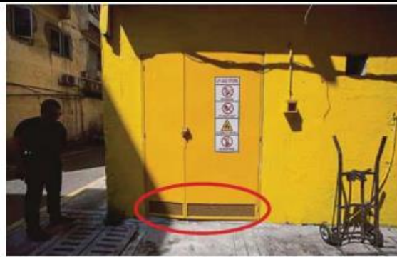
PINTU laluan udara gas yang terdapat di sebuah dobi layan diri di Kuala Lumpur.
