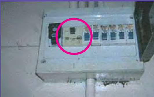
Gambar 2 :Peranti Arus Baki (PAB) bertanda bulat yang dipasang tidak beroperasi kerana mengalami kerosakan
