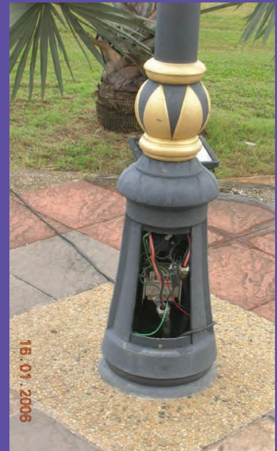
Gambar 7 : Sambungan wayar elektrik terdedah tanpa penutup
