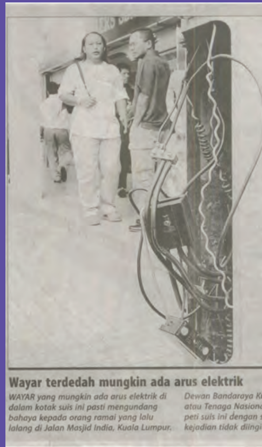
Gambar 6 : Sambungan wayar elektrik terdedah yang mengundang bahaya.
